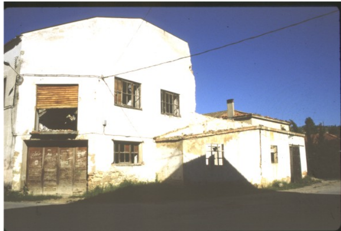
Vista de la fachada principal en la que existía un edificio anexo por la parte delantera
